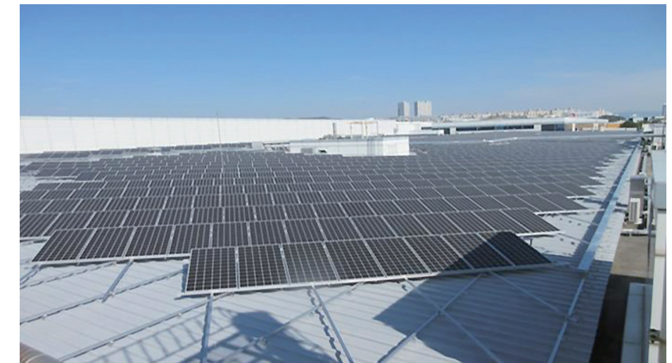
오창공장 태양광 발전 설비
